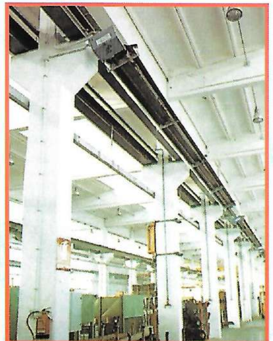
Calefacción industrial en base a tubos radiantes
